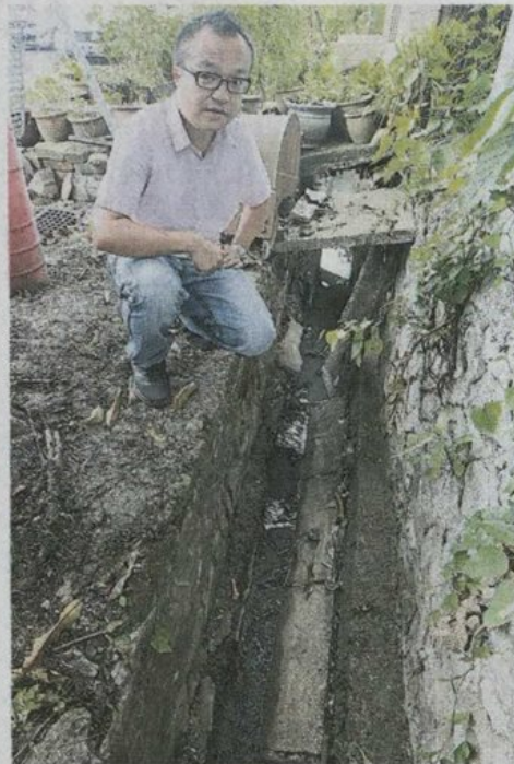
■游佳豪巡视沟渠崩塌的情况。
